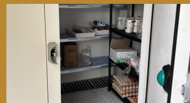
1 Nouvelle Chambre froide
